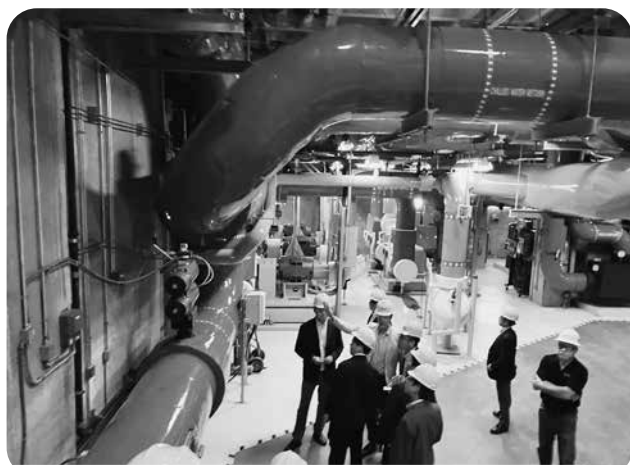
▼機械室の写真
