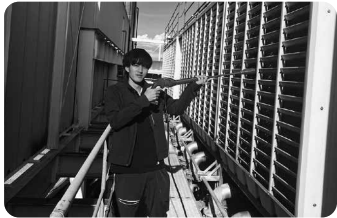
◀快適な空調のために欠かせない冷却塔清掃。
