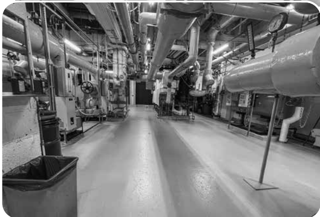
▲不要な物は一切無く通路が出来ている
